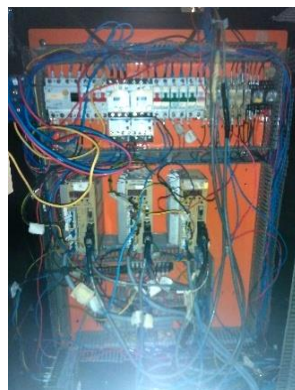
Gambar 1: Kondisi Panel Elektrik Mesin CNC Edu-Mill Sebelum Retrofit
