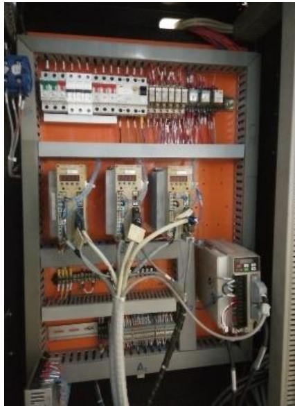
Gambar 2: Kondisi Panel Elektrik Mesin CNC Edumill Setelah Retrofit
